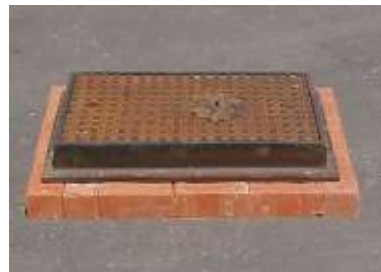
No3, 4, 5, Meter Box
